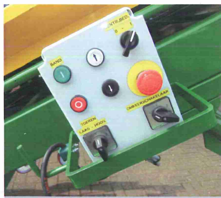
Functionele en afgeschermded Bedieningskast.
